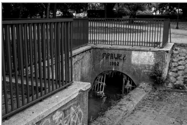
Fot. 1. Przelew burzowy na Jasieniu w Parku Widzewskim Fot. J. Jędruszkiewicz
