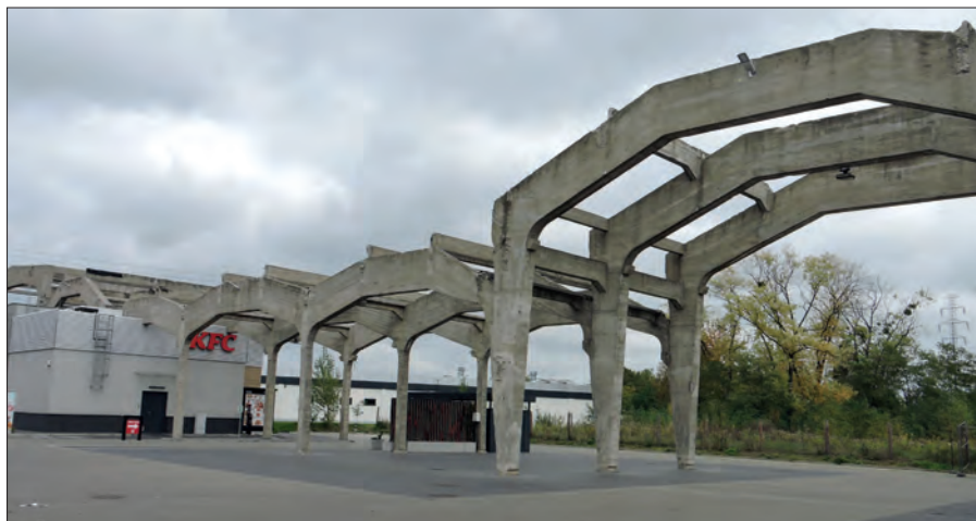
13. Dawne zakłady Towarzystwa John, Krebs i S-ka, później Fakora, pozostałości żelbetowej konstrukcji hali odlewni. Fot. K. Stefański, 2023
