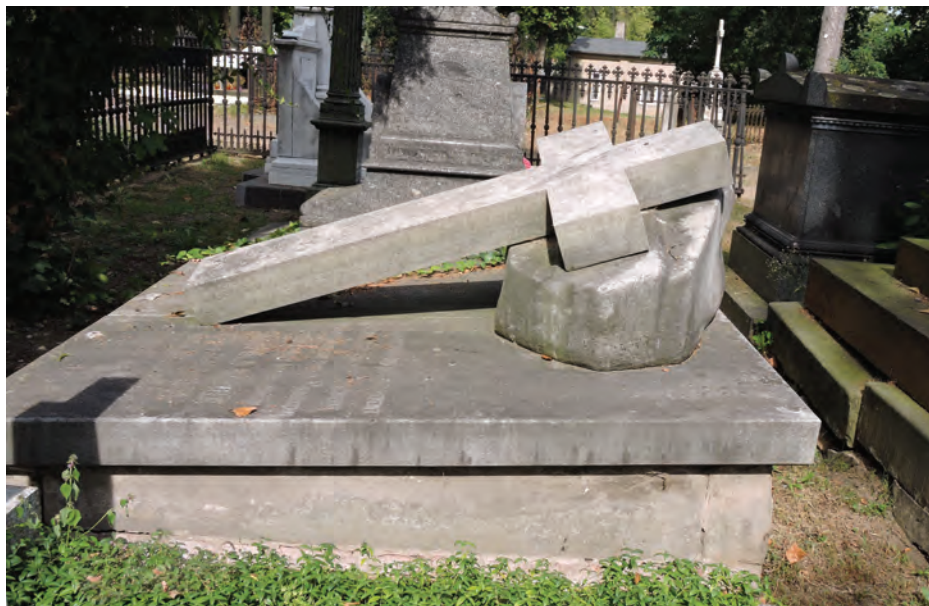
10. Pole grobowe rodzin Schlösserów i Wernerów na cmentarzu ewangelicko-augsburskim w Ozorkowie – grobowiec Pauliny i Leopolda Wernerów. Fot. K. Stefański
