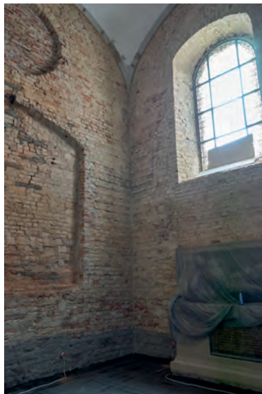
4. Wnętrze kaplicy podczas remontu w 2018 roku – widok ku południowemu zachodowi, fot. Mikołaj Potocki
