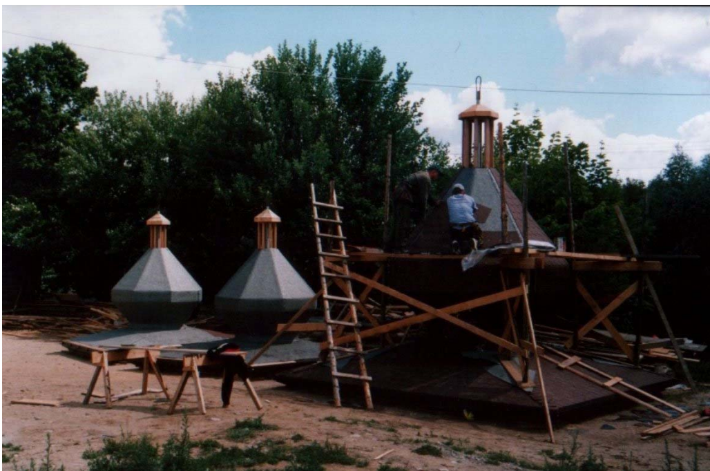
Foto. 3. Kruklanki. Trwają prace przy zwieńczeniu budynku – krycie bań cerkiewnych (zdjęcie pochodzące z badań własnych).
