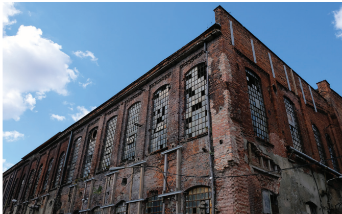
Fotografia 1. Zdegradowany budynek pofabryczny
