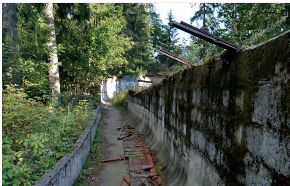
9. Zanieczyszczenia w korycie dawnego toru bobslejowego Fot. J. Panicz, wrzesień 2020 r.
