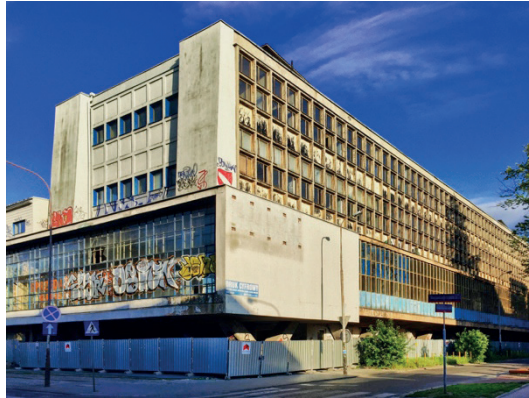
Fotografia 2. Inwestycje typu PBSA w Łodzi: gmach Łódzkiej Drukarni Dzielowej w trakcie przebudowy na hotel studencki Basecamp
