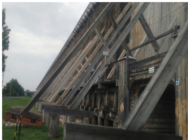
Fot. 2. Podpory dębowe pokryte nalotem solnym (fot. R. Fijałkowski)
