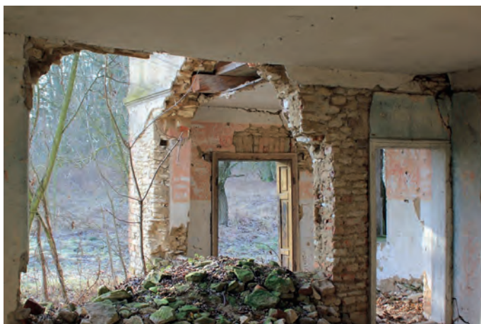
Ryc. 5. Ubytki murów w części frontowej budynku (fot. M. Gorączko, 2016)
