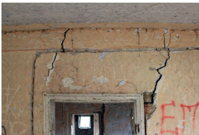
Ryc. 11. Przykładowe uszkodzenia ścian wewnętrznych (fot. M. Gorączko, 2016)
