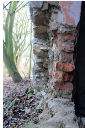
Ryc. 9. Degradacja przyziemnej części muru zewnętrznego (fot. M. Gorączko, 2016)
