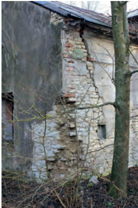
Ryc. 8. Uszkodzenia narożnika budynku (fot. M. Gorączko, 2016)
