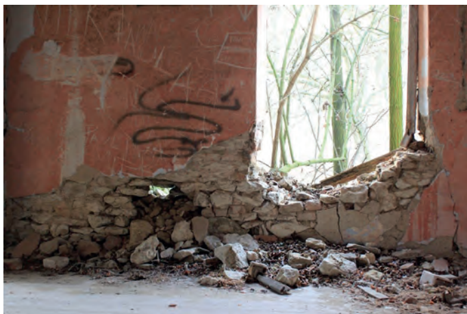
Ryc. 10. Uszkodzenia muru w strefie przyokiennej (fot. M. Gorączko, 2016)
