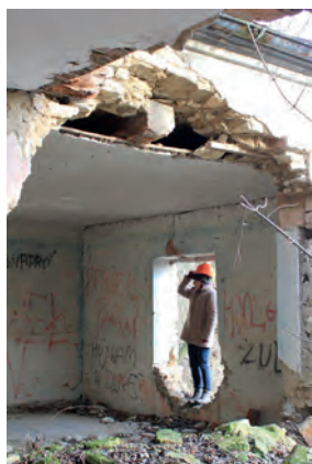
Ryc. 6. Brak podparcia stropu w zrujnowanej części frontowej budynku (fot. M. Gorączko, 2016)
