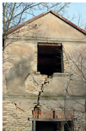
Ryc. 7. Pęknięcie muru w obrębie ryzalitu części frontowej budynku (fot. M. Gorączko, 2016)
