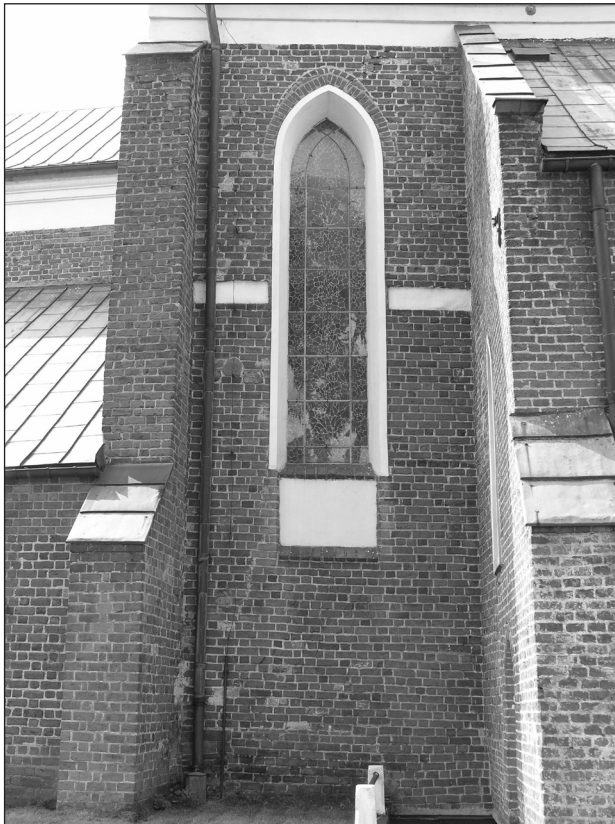
Ryc. 9. Szadek, kościół parafialny, pln. elewacja korpusu, okno w pierwszym przęśle od wsch. Wokół otynkowanej wnęki pod parapetem cegła maszynowa. Nad ostrołukowym zamknięciem grzbiet pierwotnego łuku. W połowie wysokości ściany pas wgłębnego fryzu. Stan przed konserwacją
