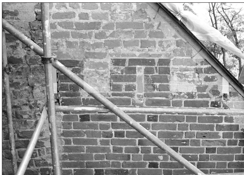
Ryc. 25. Szadek, kościół parafialny, górna partia wsch. elewacji kaplicy Matki Bożej Różańcowej. Zarysy dawnej attyki w formie krenelaża z otworami szczelinowymi. Wyżej późniejsza nadbudowa z wykorzystaniem materiału rozbiórkowego Źródło: fot. Dominik Bodzioch, 2013
