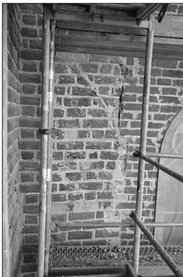
Ryc. 10. Szadek, kościół parafialny, przypora korpusu widoczna we wsch. elewacji kaplicy Matki Bożej Różańcowej. W ścianie przypory ukośnie schodząca linia – zamknięcie pierwotnej wysokości; wyżej nadbudowana część przypory Źródło: fot. Dominik Bodzioch, 2013
