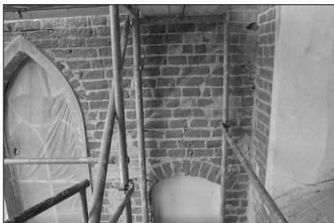
Ryc. 23. Szadek, kościół parafialny, zach. elewacja kaplicy Matki Bożej Różańcowej. Nad zamurowanym i wysoko usytuowanym wejściem ukośna bruzda – ślad po dawnym zadaszaniu. Przy ostrołukowym oknie fragment grzbietu pierwotnego łuku o przebiegu półkolistym
