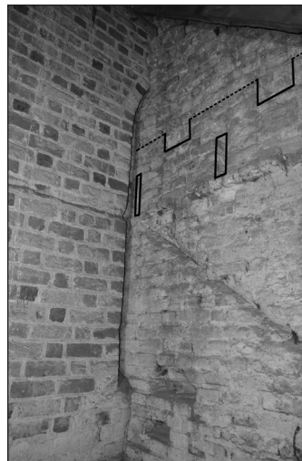
Ryc. 18. Szadek, kościół parafialny, pn. elewacja korpusu, trzecie przeszło od wsch. – sytuacja widoczna na poddaszu kaplicy. Zach. ściana kaplicy dostawiona do zamurowanego okna w korpusie. W obu ścianach bruzdy po połaci dawnego dachu pogrążonego. W zach. ścianie kaplicy, nad nieznacznie wysuniętą półką, zarysy krenelażowej attyki z otworami szczelinowymi
