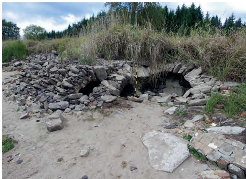
Obr. 3. Klenby sklepů zbořených budov odhalené díky vodní erozi (foto L. Funk, září 2015).
