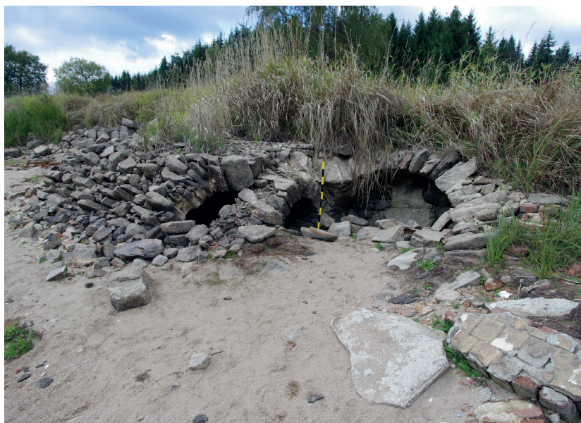
Obr. 3. Klenby sklepů zbořených budov odhalené díky vodní erozi (foto L. Funk, září 2015).
