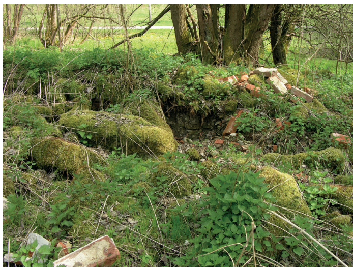
Obr. 9. Mikulov (Böhmdorf), k. ú. Mikulov: destruovaná usedlost v části A zaniklé vesnice se zbytky ponechanými v místě – stav v roce 2011 (foto M. Bureš, duben 2011).
