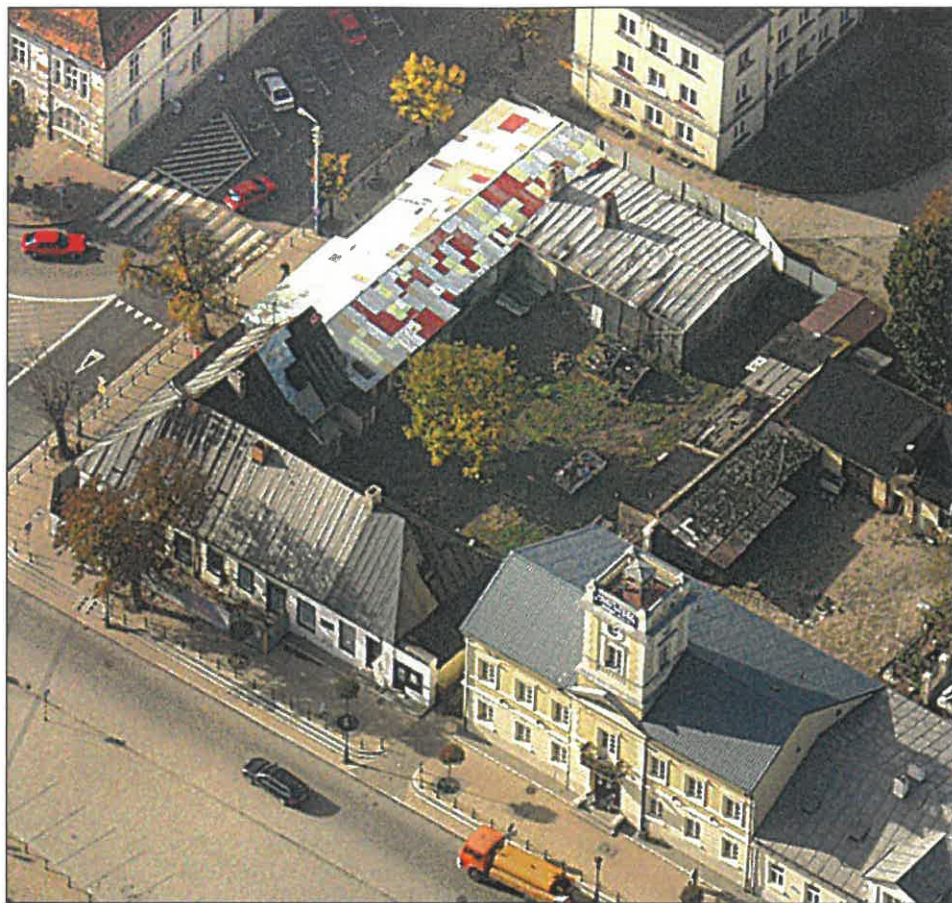
Fot. 18. Królewski pałac podróżny zabezpieczony po pożarze fot. P. Filipowicz
